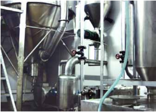
冷冻除湿冷却系统
